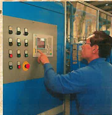
Am Operator Panel Simatic OP270 jeder Einheit kann der Bediener bei Bedarf korrigierend in den laufenden Prozess eingreifen
